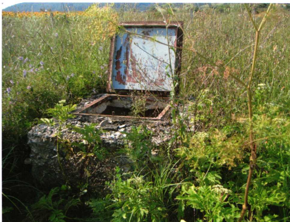
Външен вид на каптажната шахта на извор „Кю бунар“
